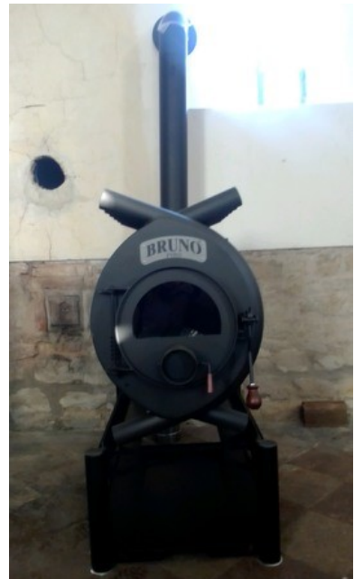
„Bruno“ heizt jetzt richtig ein
